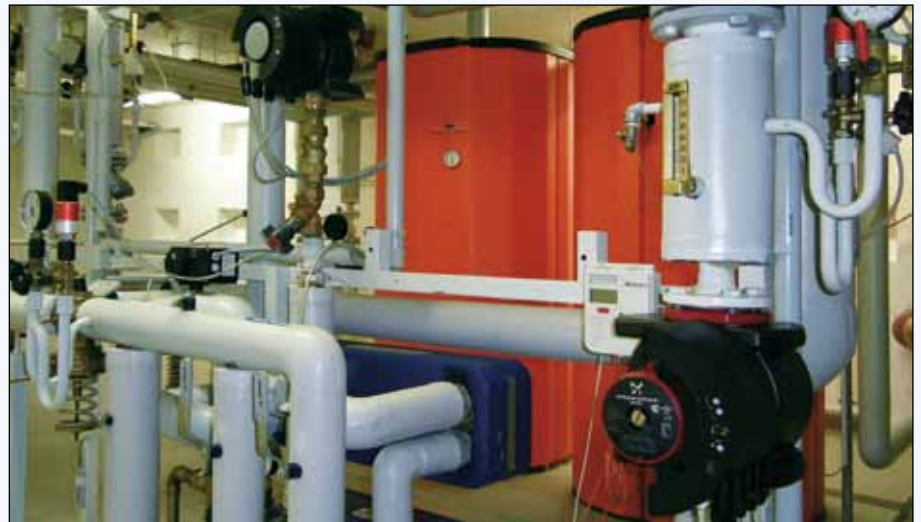
Moderne Hausanschlussstation mit Hocheffizienzpumpen
